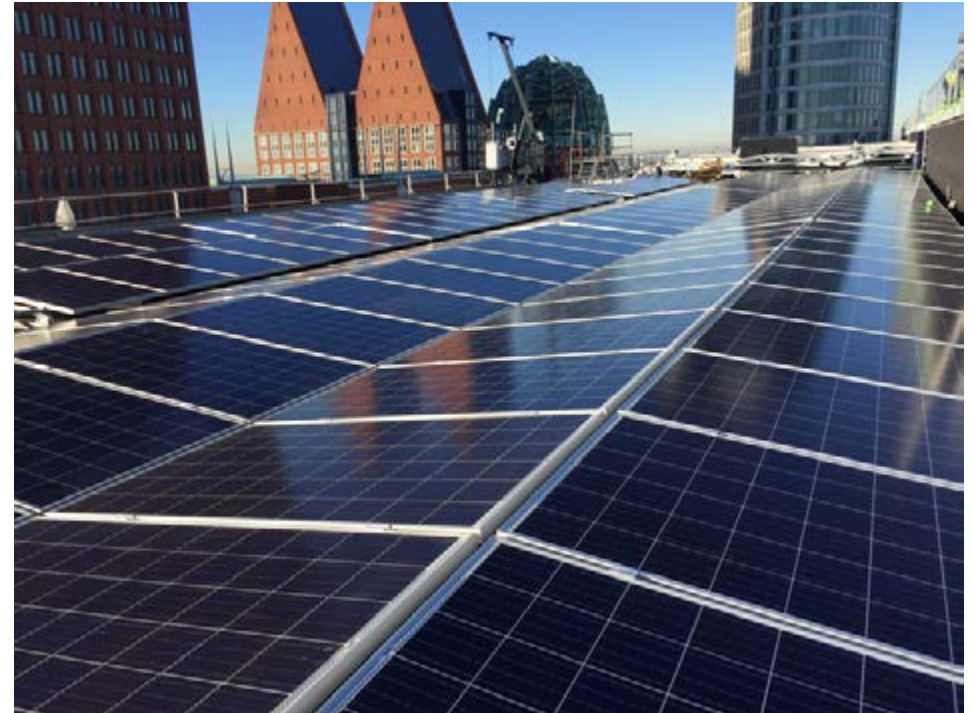
Zonnepanelen op het dak van Rijnstraat 8. Foto: Oranjedak Energy
