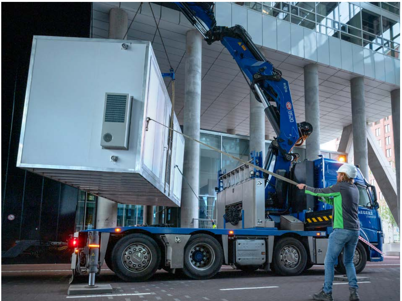
Foto | Plaatsing van de Stadsbatterij in de onderdoorgang van Rijnstraat 8 in Den Haag.
