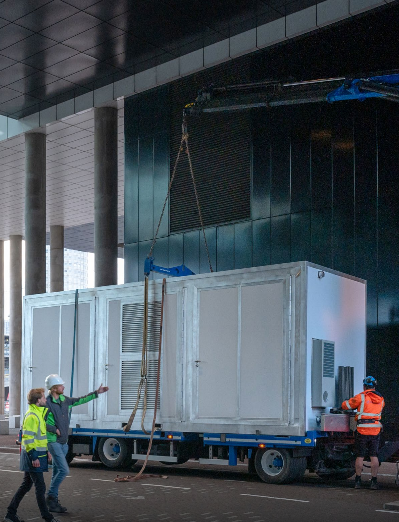
Op 24 oktober 2023 is de Stadsbatterij in de onderdoorgang van Rijnstraat 8 in werking gesteld. ©Rijksvastgoedbedrijf, foto Bas Kijzers
