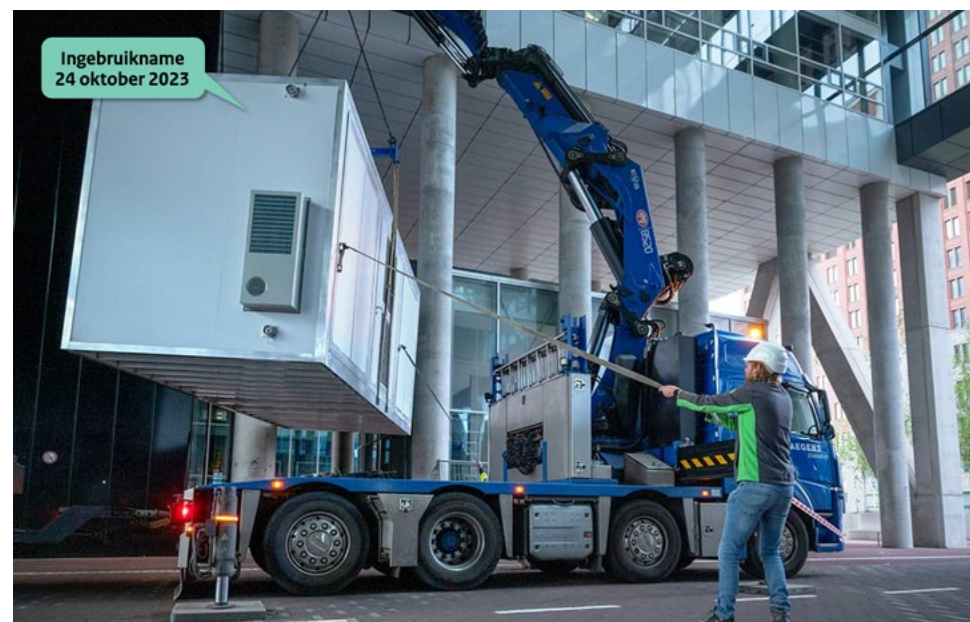
AFBEELDING 2 | Plaatsing van de Stadsbatterij in de onderdoorgang van Rijnstraat 8 in Den Haag. Met de Stadsbatterij is een grote grootschalige batterij-opslag voor Rijnstraat 8 gerealiseerd waarmee ervaring kan worden opgedaan en kennis kan worden gedeeld met vastgoedbeheerder en professionals in de energietransitie. ILLUSTRATIE | Anne-Louise Bergkamp
